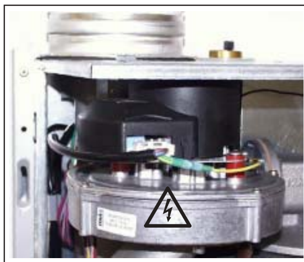
Рис.: Штекер вентилятора: опасность от электрического напряжения
