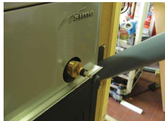
Εικ. 28 Θερμοστάτης ασφαλείας
