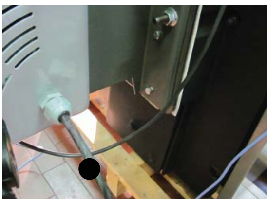
Εικ. 37 Σύνδεση στο ηλεκτρικό δίκτυο
