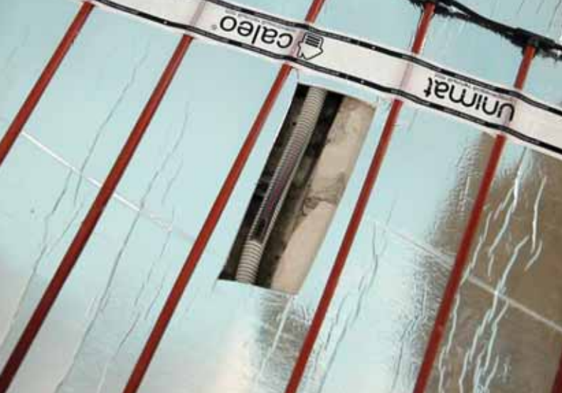
Рис. 17. Установка датчика температуры пола SF 4x15 между стержнями UNIMAT в гофрированной трубе
