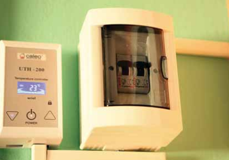
Рис. 19. Установленный терморегулятор на стене
