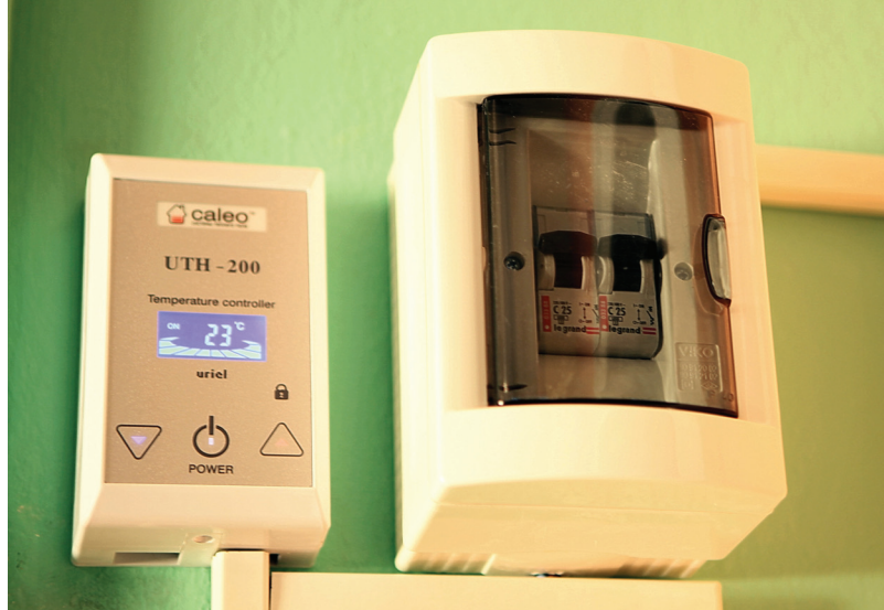
Рис. 27. Терморегулятор, подключенный к сети через отдельный автомат
