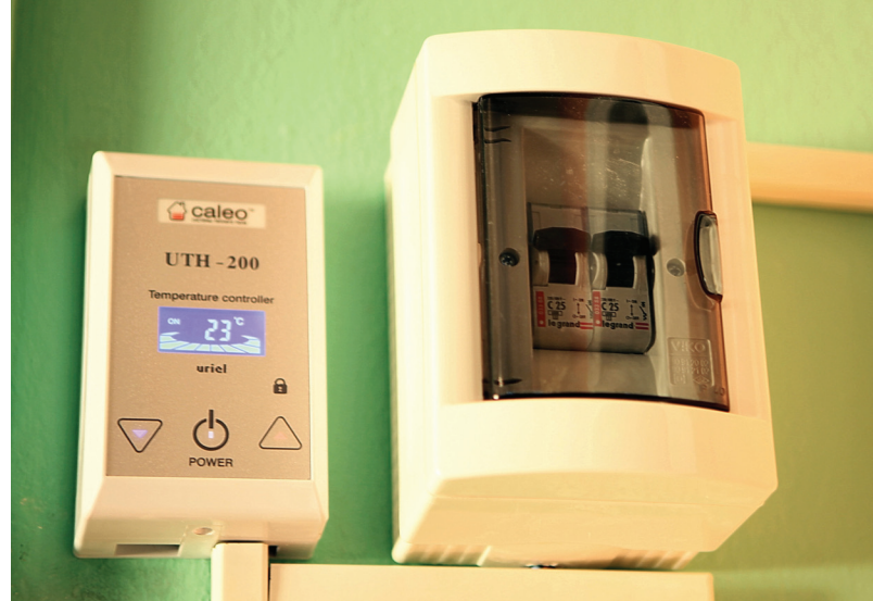
Рис. 27. Терморегулятор, подключенный к сети через отдельный автомат
